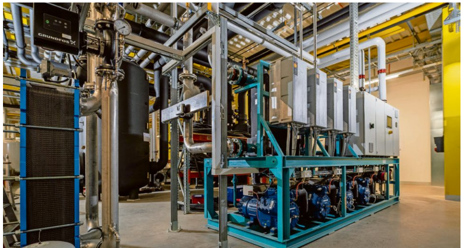
Die neue Wärmepumpe im Blum-Werk 4 (Bereich 1): Effizient und umweltfreundlich.
