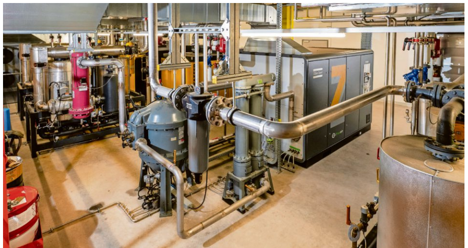
Kompressoren im Werk 4 (Bereich 1) in Bregenz.
